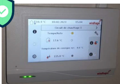
Présence d'un système de régulation de classe V avec son thermostat
